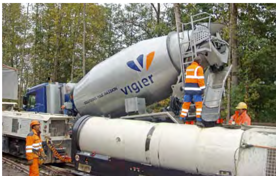
► Réalisation par Vigier Béton d'une galerie de délestage pour éviter les crues
