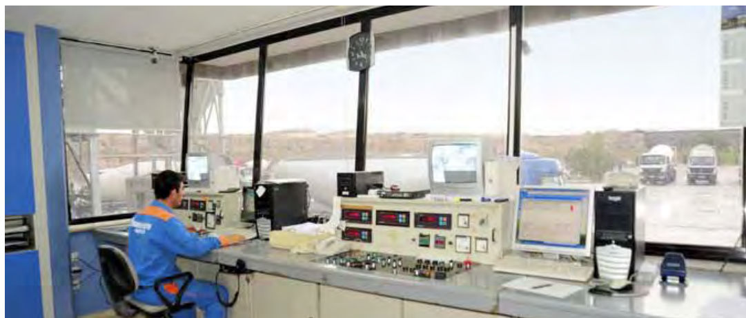
▼ La cabine de commande de la centrale à béton de Merkez (Turquie)
